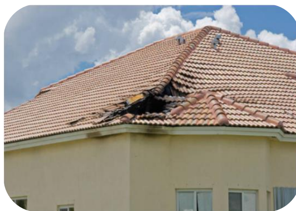
Figura. 4 Dano causado por raio a uma casa. [11]
